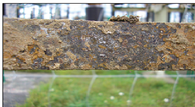
Makročlánková vzdálenost mezi zmineralizovaným Zn povlakem a intenzivní důlkovou korozi oceli (obr.12) řádově půl metru.
