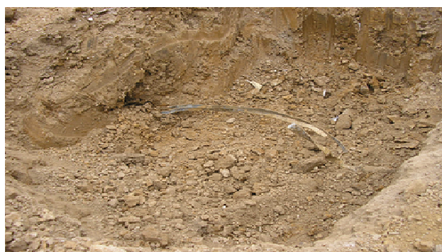
Ohrožená FeZn páska ve výkopu pro základ rozšíření 110 kV rozvodny
