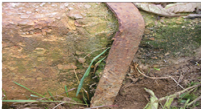
Intenzivní koroze nezaizolované uzemňovací pásky na rozhraní fázi vzduch - půda
